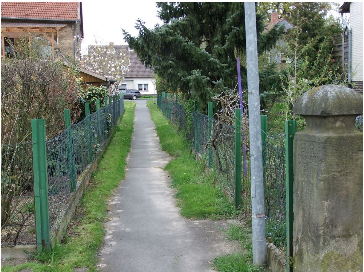
Die Befestigungen der separaten fußläufigen Wegeverbindungen in Soßmar bedürfen einer Erneuerung.
