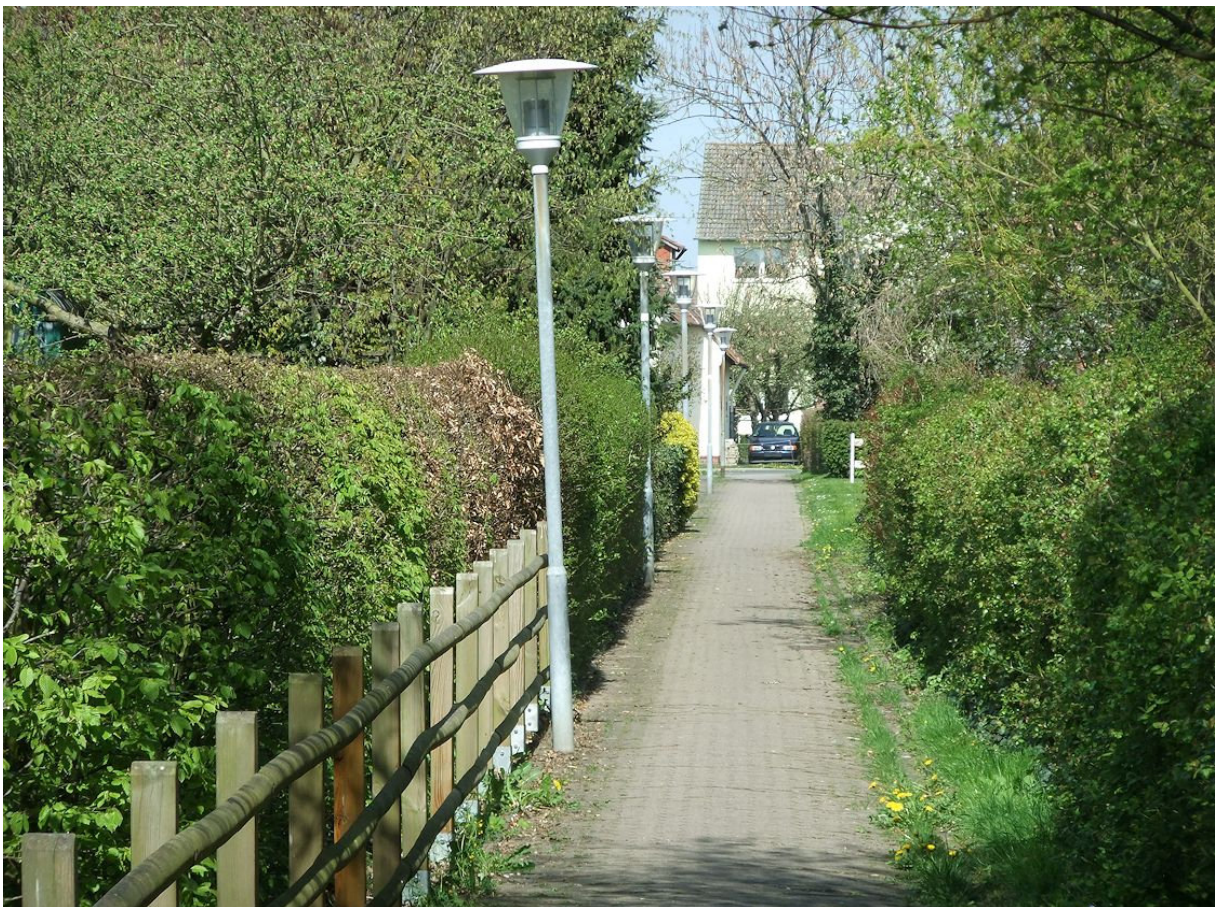
Der fußläufige Verbindungsweg zwischen Hauptstraße und An der Sporthalle in Mehrum wird als Brötchenweg bezeichnet; die Pflasteroberfläche weist Schäden auf.
